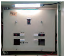
配電盤內部照明
